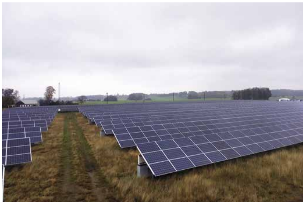
Solcellsanläggningen sydväst om Sjöbo. Samtliga foton på detta uppslag: Arne Ohlsson.
